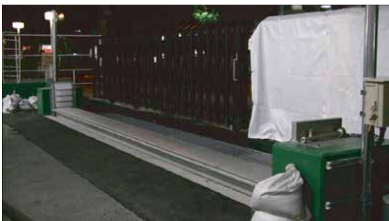
遮水システム浮上テスト ※営業施設のため夜間検証
